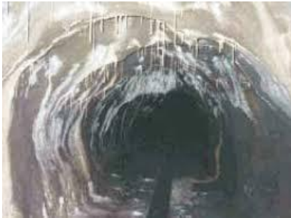
Dégradation par ruissellement de l'eau
