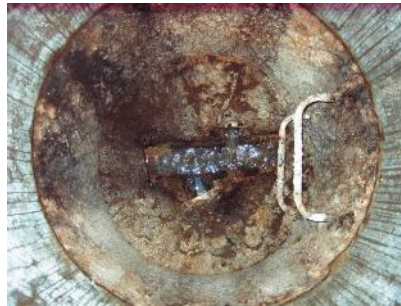
Dégradation H 2 S d'un réseau d'assainissement
