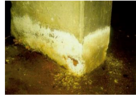
Dégradation pied de poteau par attaque sulfatique
